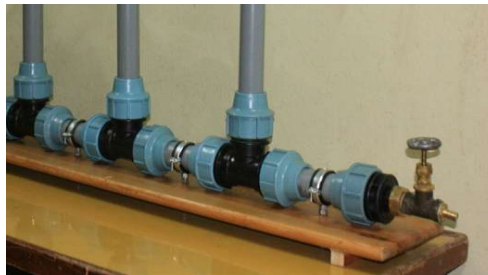
Рисунок 2 — Фото трубопроводу для обробки води в потоці з трьома вузлами обробки
